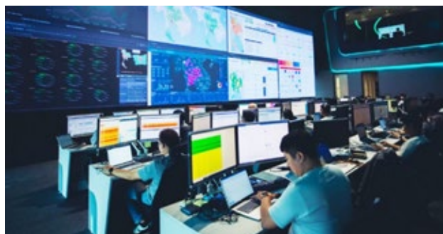
ศูนย์ควบคุมเครือข่าย Business Network Intelligence Center (BNIC)
