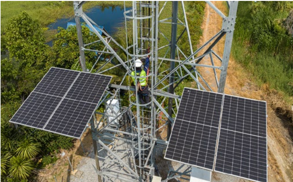
การติดตั้งและใช้พลังงานแสงอาทิตย์ทดแทนการใช้ไฟฟ้าจากระบบสายส่ง
